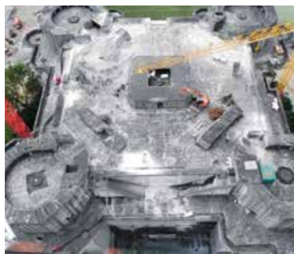
Die Lasten der Aufstockung müssen sehr gezielt auf eine begrenzte Fläche der Bunkerdecke abgeleitet werden.
