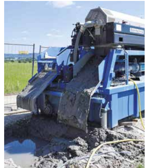
Das zu entsorgende Spülmateriale sowie grobe Fels- und Gesteinsreste werden in Gruben oder Containern gesammelt und anschließend abtransportiert.
