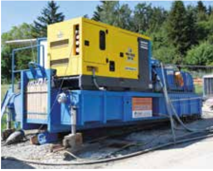
Abb. links: Dank der mobilen Separationsplattform MRS 350 + kann dieselbe Spülflüssigkeit mehrfach im Kreislauf eingesetzt werden.
