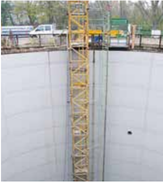
Abb. 10: Kranurm als Leiteraufstieg
